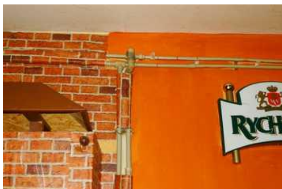
Rozvody topné vody ústředního topení
