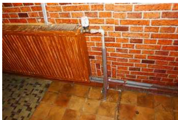
Rozvody topné vody ústředního topení
